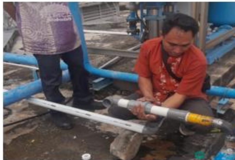
REKAYASA STOP ROOF TANK YANG RUSAK
