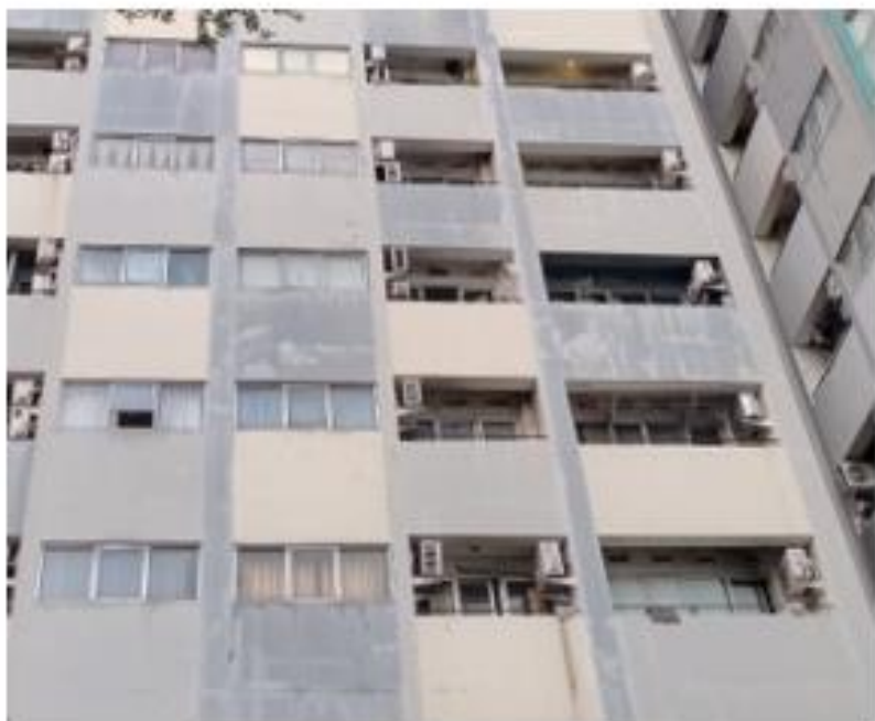
FASAD BANYAK KEBOCORAN DAN CAT RUSAK
