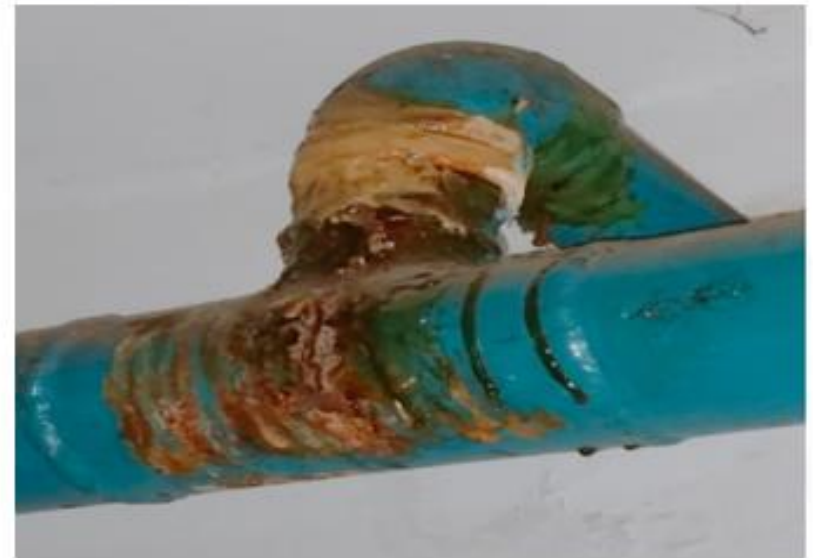
Kerusakan Pipa Instalasi Air Bersih
