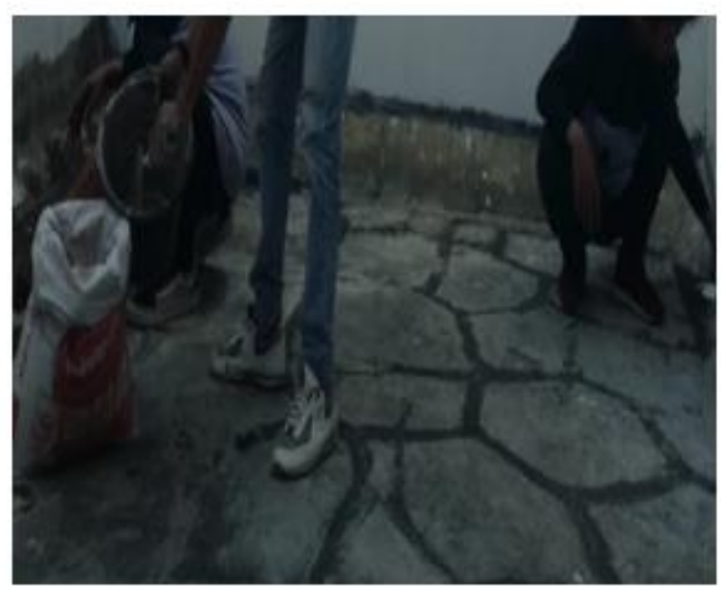
Lantai Atap Retak Bocor
