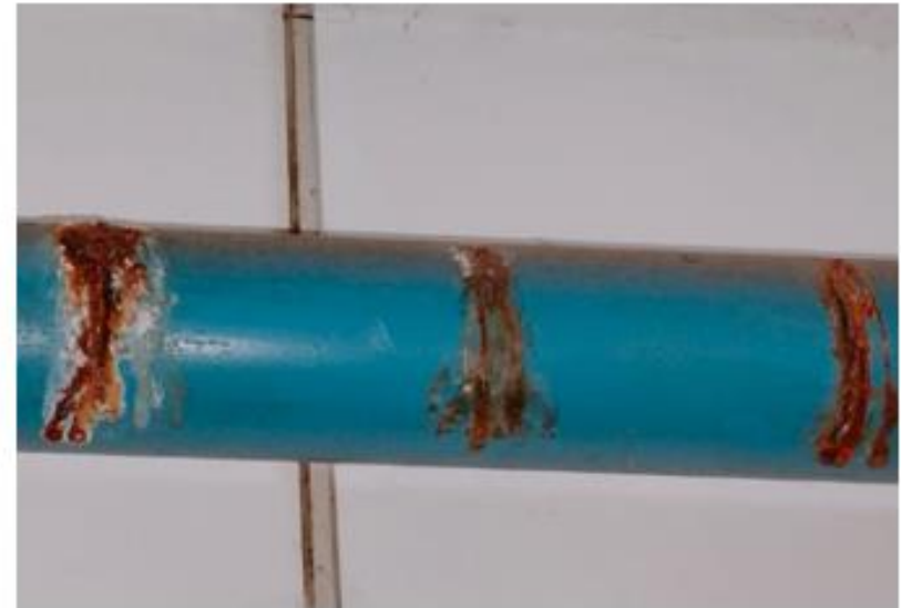
Perlu Penggantian instalasi Pipa
