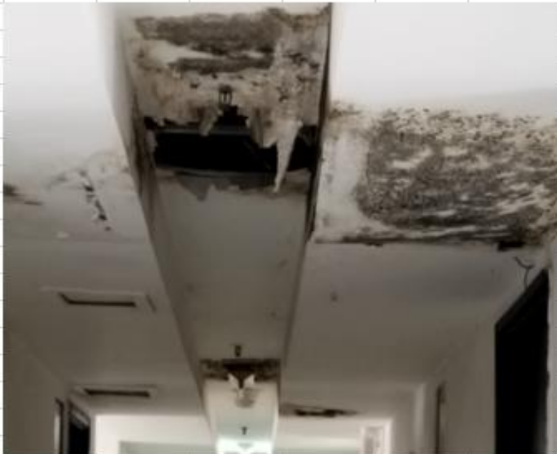
Plafond dan Dinding Rusak
